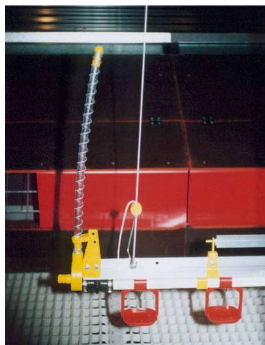
Nippalinjan loppupäässä olevasta ilmausputkesta näkyy veden paine linjan lopussa. Ilmausputki voidaan kääntää sivulle huuhtelun helpottamiseksi. Tällöin huuhteluvesi tulee suoraan letkuliittimestä ja huuhtelu on tehokasta.
